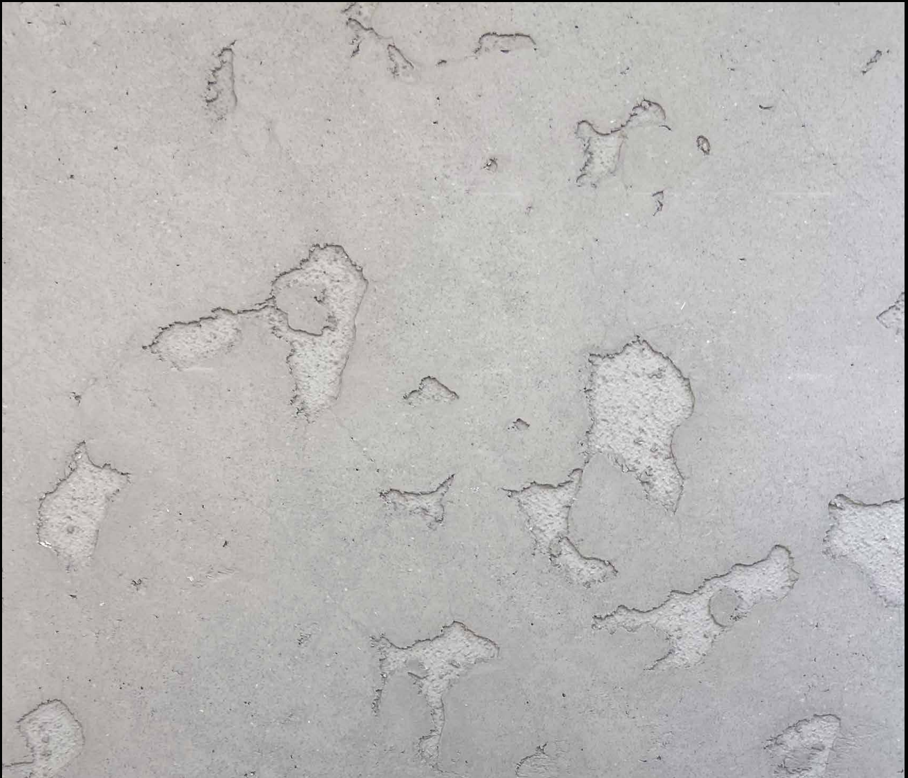
BROKEN BÉTON - OX 53
